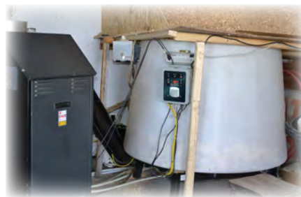
Chaudière et réserve
