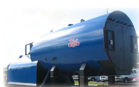
La chaudière du CHSLD
